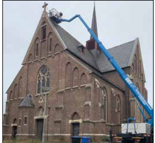
Auch Notreparaturen – wie hier kurz vor Weihnachten – helfen nicht mehr. Das Dach muss komplett erneuert werden.
